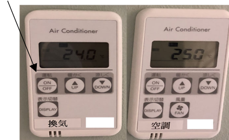
写真 1 空調・換気スイッチの設置
